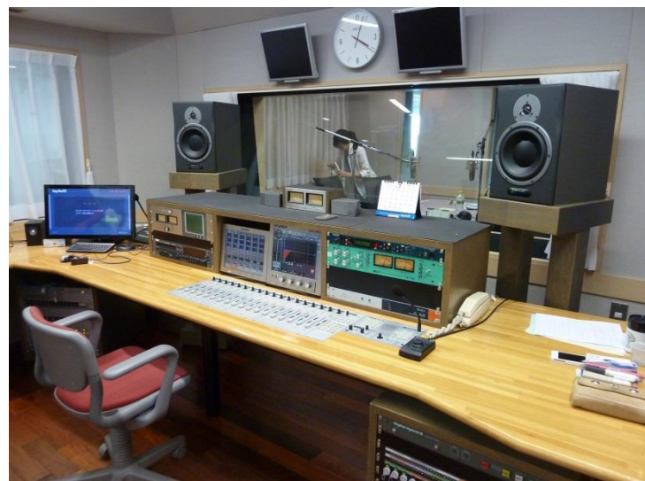
デジタル化された 調整室
